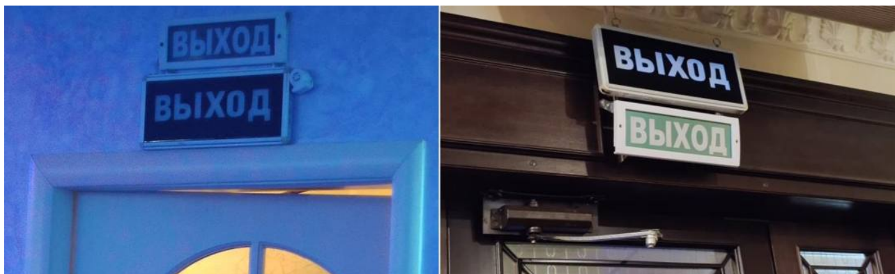
Рис. 3. Одновременное размещение световых указателей «ВЫХОД» аварийного эвакуационного освещения и системы управления эвакуацией людей над одной дверью
